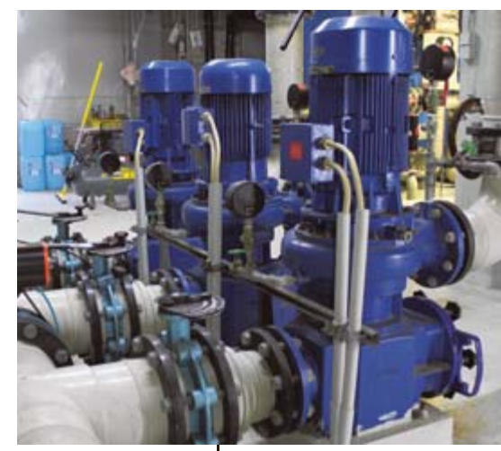
Die drei Umwälzpumpen bringen das abgebädete Wasser aus den Wasserspeichern ins Aufbereitungssystem. Sie haben eine Leistung von je 7,5 Kilowatt und es werden 70 bis 125 Kubikmeter in der Stunde und pro Pumpe Wasser gefördert. Es laufen bei Badebetrieb (Starklastzeit am Tag) immer zwei Pumpen und bei Ruhebetrieb (Schwachlastzeit bei Nacht) eine. So entsteht ein Volumenstrom von 200 Kubikmetern pro Stunde.
