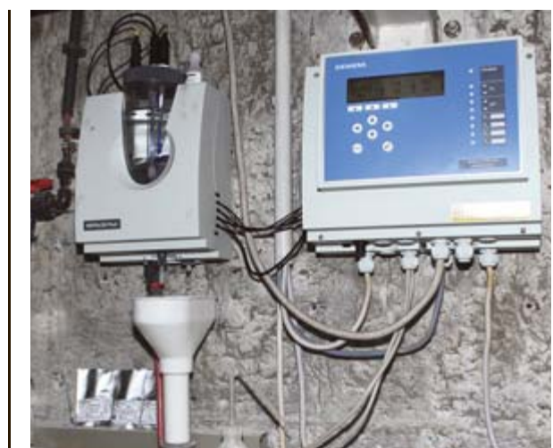
Wichtig für die Qualität des Wassers ist die Mess- und Regeltechnik . Sie entnimmt über eine Messwasserleitung ständig Proben des abgebädeten Wassers. Drei Elektroden messen die vorgeschriebenen Richtwerte: Die Werte für freies Chlor (0,3 bis 0,6 Milligramm pro Liter) und pH (6,5 bis 7,6) sowie die Redox-Spannung (750 Millivolt), die die Bakterien-Abtötungs-Geschwindigkeit angibt. Außerdem wird die Temperatur gemessen. Nun schickt das Gerät Signale an die Chlorgasanlage, den pH-Regler und die Wärmetauscher, die automatisch ihre Leistung verändern, um die Richtwerte zu erreichen.
