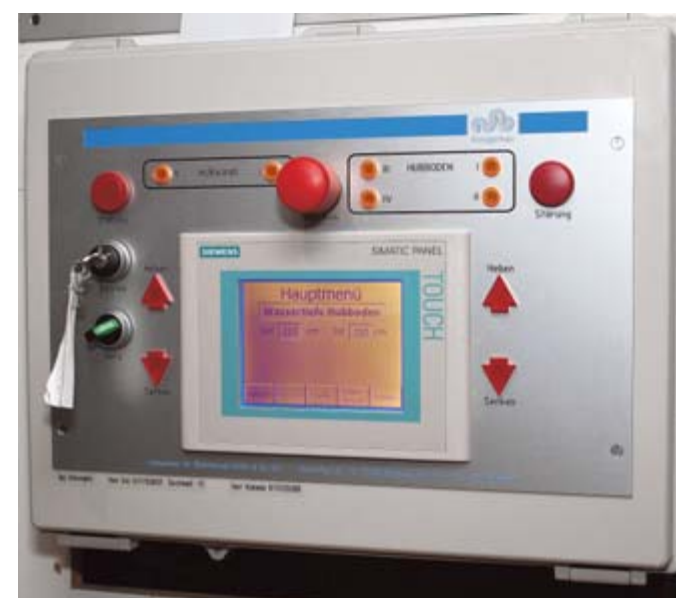
Eine besondere Technik steuert diese Armatur. Mit Hubwand und -boden lassen sich aus dem Hallenbad-Becken ein großes und ein kleines machen und die Schwimmtiefe verstellen. Zu Zeiten von Kursen, Früh- und Mittagsschwimmen ist die Hubwand herabgelassen und die Beckentiefe einheitlich auf 2,10 Meter eingestellt. Für das Familienbad separiert die Hubwand einen Nichtschwimmerbereich von 10 Metern Breite und 13 Metern Länge, der unter der Woche (ausgenommen mittwochs) zwischen 14 und 18 Uhr 0,80 Meter, zwischen 16 und 18 Uhr 1,30 Meter tief ist. Auch mittwochs (14 bis 17 Uhr), samstags (12 bis 17 Uhr) und sonntags (10 bis 17 Uhr) können die ganz Kleinen bei einer Beckentiefe von 0,80 Metern gefahrlos baden.
