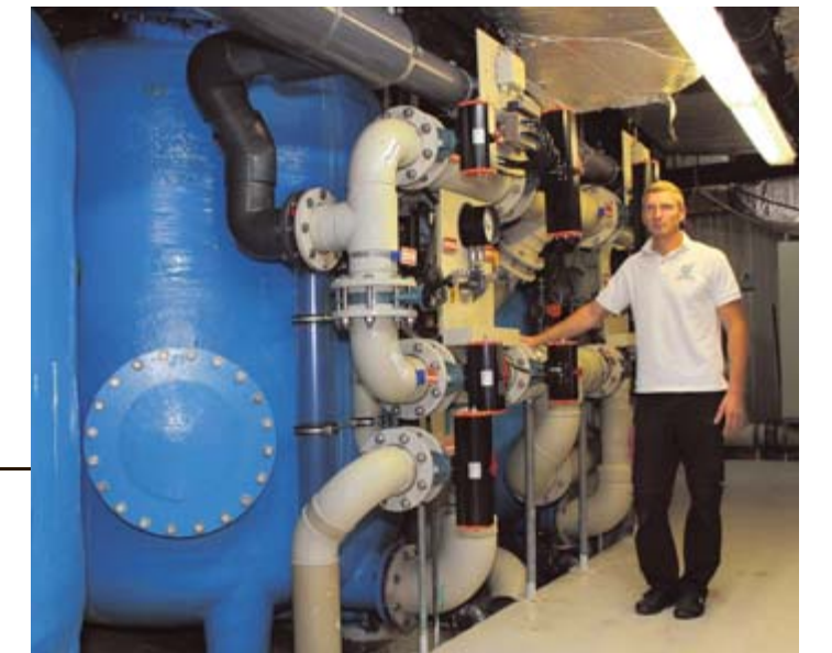
Die nächste Station des Wassers ist der Weg durch zwei Aktivkohlefilter . Die Fließrichtung des Wassers im Rohrsystem kann mit pneumatisch gesteuerten Schiebern (schwarz-oranger Kasten) geändert werden. Im Normalbetrieb fließt es in die eine, zur Reinigung der Behälter in die andere Richtung. Die Aktivkohle filtert noch nicht zerfallenes Restozon aus dem Wasser. Carsten Wienke, stellvertretender Bäder-Betriebsleiter, macht deutlich, wie groß die 1200 Liter fassenden Aktivkohlefilter-Behälter sind.
