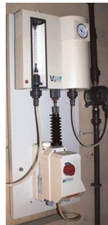
Die Chlorgasanlage leitet Chlor in das gefilterte Wasser. An die Vollvakuumanlage sind zwei Chlorgasflaschen mit je 65 Kilogramm flüssigem Chlor angeschlossen. Ein Ventil, gesteuert durch die Mess- und Regeltechnik, bestimmt die Dosierung. Das Wasser wird desinfiziert. Außerdem entsteht im Becken eine Depotwirkung, die, auch wenn das Wasser die Aufbereitungsanlage verlassen hat, desinfizierend wirkt. Chlor ist in zu hoher Dosis allerdings auch giftig. Wer in der Chlorgasanlage arbeitet, um beispielsweise die Gasflaschen auszutauschen, muss einen Atemschutz tragen. Im Falle eines Defekts bindet eine Beregnungsanlage das austretende Chlor.
